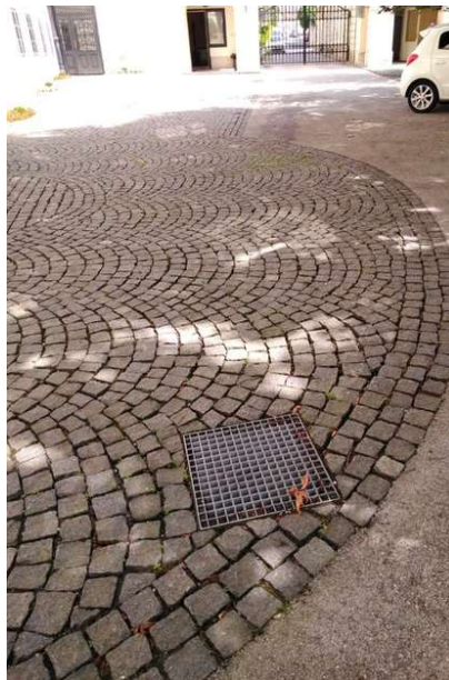
Ulazno dvorište – odvodnja oborinske vode loše riješena, nema dovoljno odvodnih slivnica, krivi padovi
