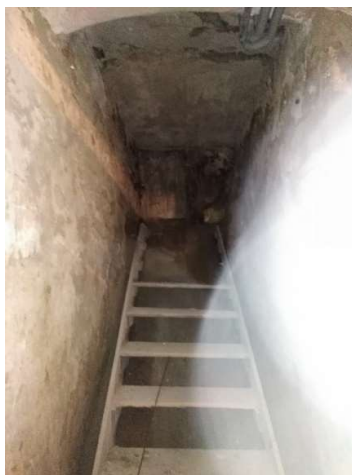
Zidovi podruma – vidljivo djelovanje kapilarne vlage i soli;
